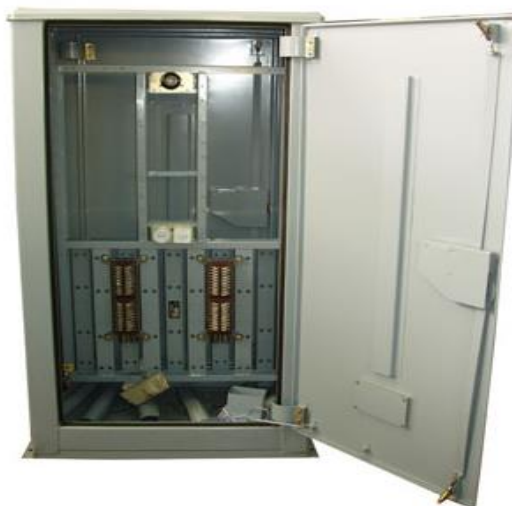
Рисунок 1 – Шкаф магистральной линии связи типа ШМС
